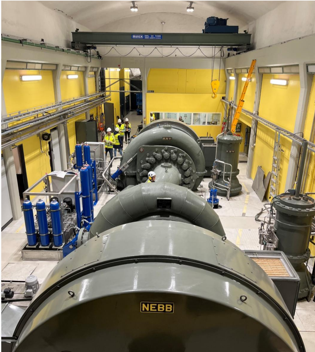
Øvre Tessa Kraftverk har gjennomgått omfattende rehabilitering i 2025. Rehabiliteringen har vært planlagt i lang tid og arbeidet startet opp i februar, kraftverket ble satt i drift igjen i starten av september. Foto: Eidefoss Vannkraft AS
